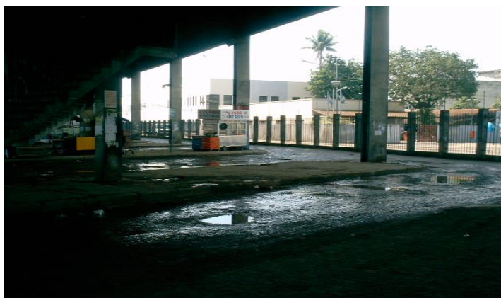
Foto 4: Precarização do antigo Terminal do Canal na subárea 5 (2005).
